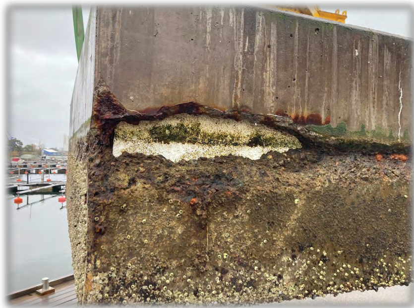
Betongen vittrat bort och frigoliten är synlig = mikroplaster kommer ut i havet som fiskar äter :-(. Foto Roger Eriksson
